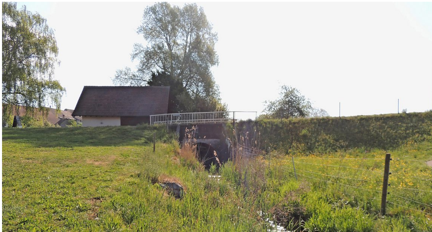
Der Bachdurchlass an der Altemerstrass muss saniert werden. Ab 4. Mai wird dafür ein Teilabschnitt der Strasse gesperrt. Foto: Eva Wanner
